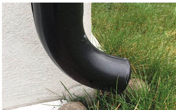
Bilde 1: Frakobling av taknedløp kaster vannet ut på plenen og reduserer muligheten for oversvømmelse av kjeller.
