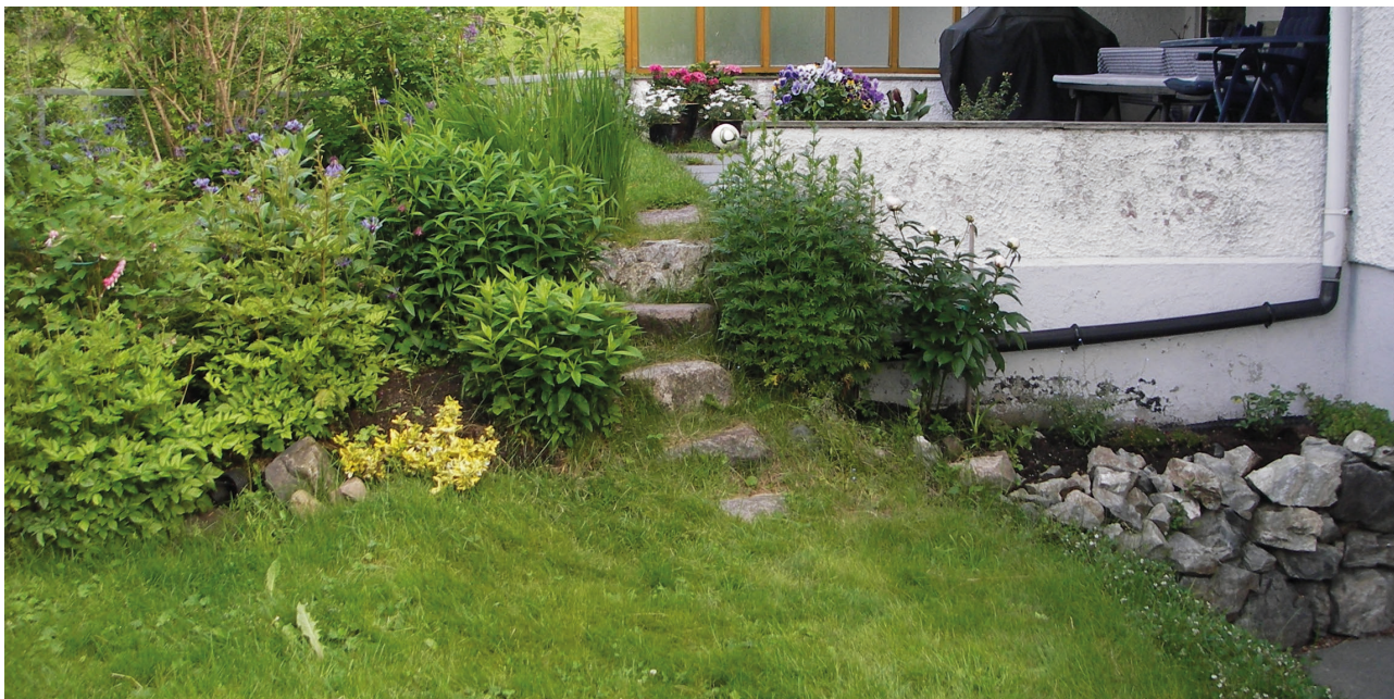
Bilde 4: Taknedløpet er forlenget inn i blomsterbed, med utløp i plenkanten (detaljebilde over).
