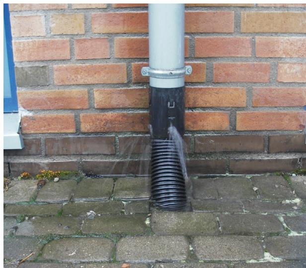
Bilde 5: Taknedløp med underjordisk avløp kan lettere tettes, med vannskade og frostsprengning av røra som resultat.
